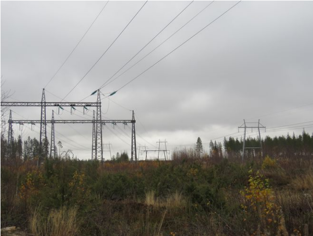
Kuva 23. Pirttikankaan sähköasema, koilliseen.
