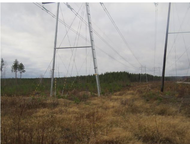
Kuva 25. Linja Humpinmäen kohdalla, länteen.
