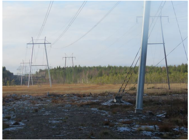
Kuva 10. Pyhäjärvi – Vuolijoki 100 kV linja Korkeamäensuolla, kuvattu lounaaseen.
